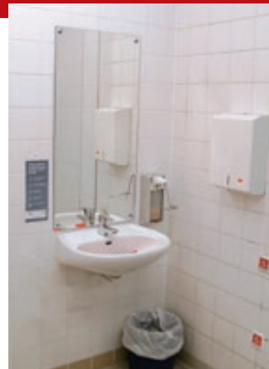
IGS RODERBRUCH, SPORTHALLE HANDWASCHBECKEN
