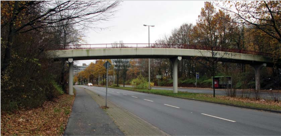
Bornumer Straße: Sanierungsbedürftiger Fuß-/Radweg, Bus- haltestelle Richtung Süden, Bestand (Büro Früh)
