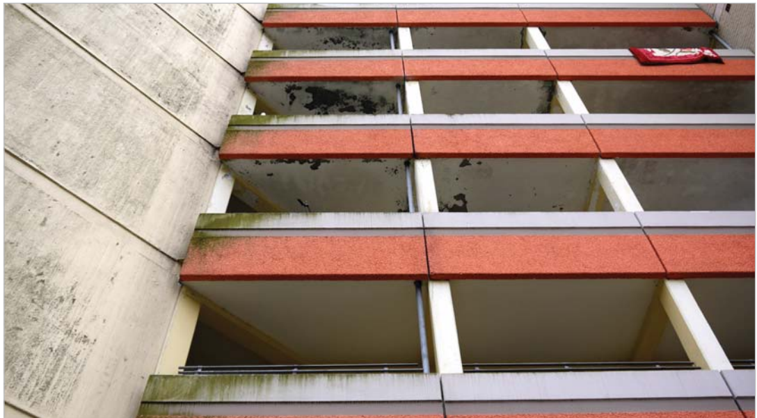
Sanierungsbedarf Großwohnanlagen Mühlenberg (LHH)
