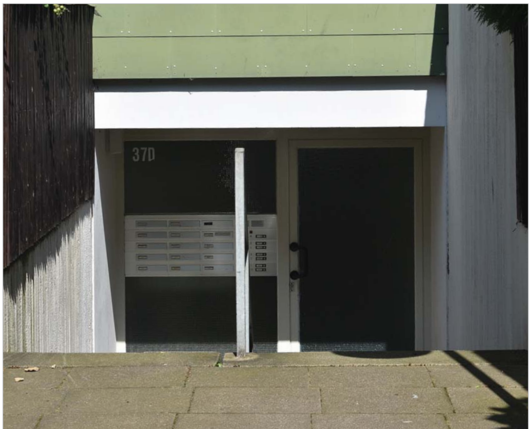
Hauseingang nicht barrierefrei (LHH)
