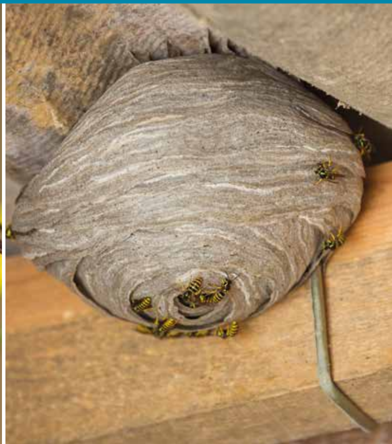
Wespennest unter dem Dach
