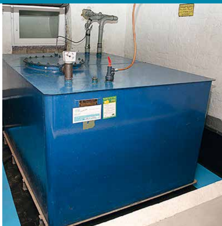
Einwandiger Stahltank in sanierter Auffangwanne
