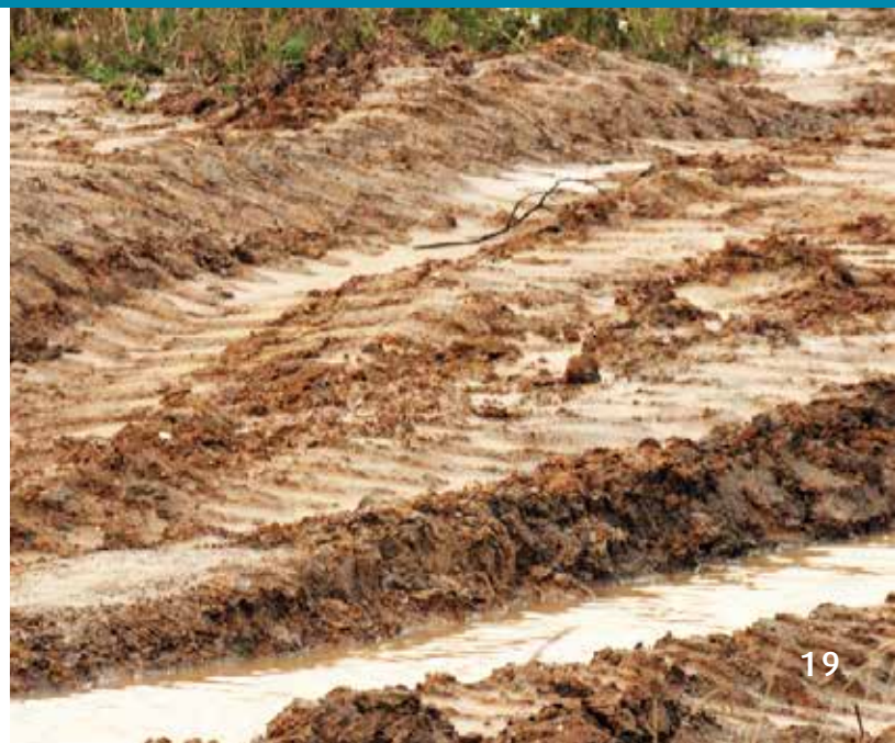
Durch Befahren stark verdichteter Boden
