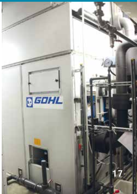
Kühlturm eines Verwaltungsgebäudes
