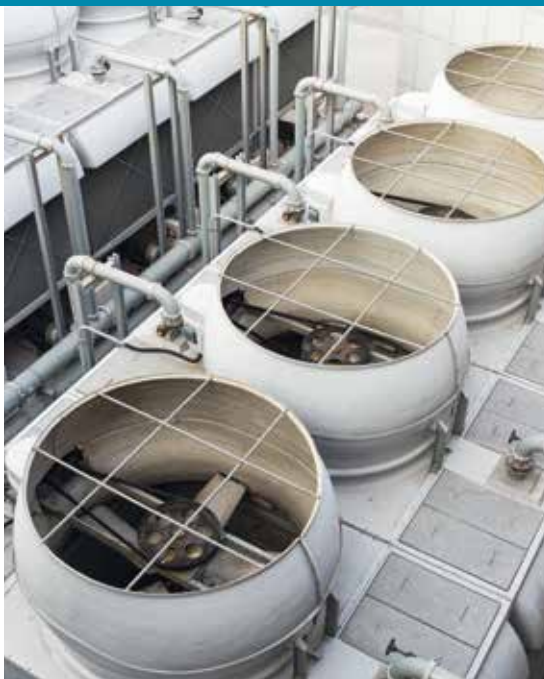
Verdunstungskühlanlage auf Gebäudedach
