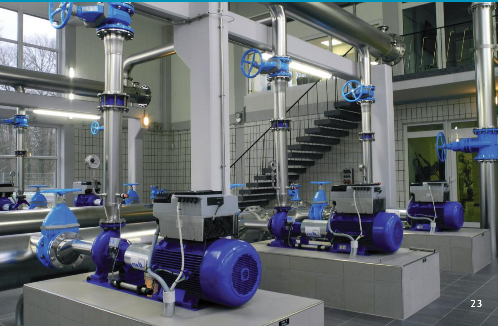
Wasserwerk Forst Esloh: Trinkwassernetz-Pumpen (Quelle Wasserverband Garbsen-Neustadt)
