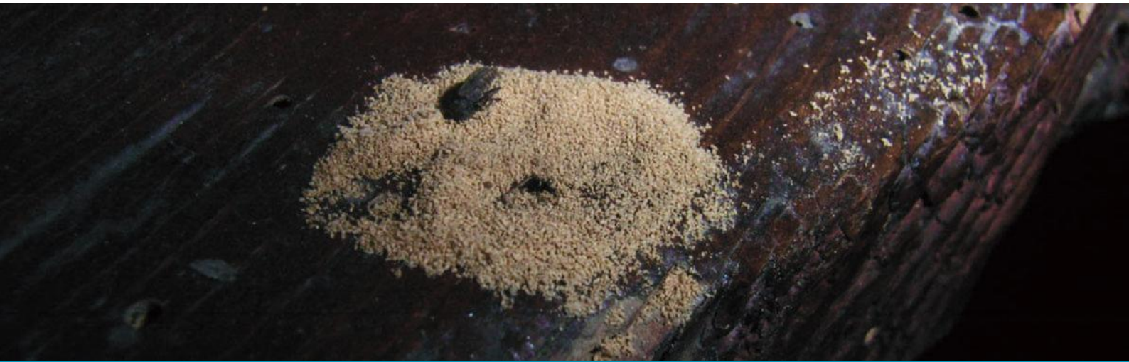
Sichtbarer Befall mit Holzschädlingen an einer Kirchenbank
