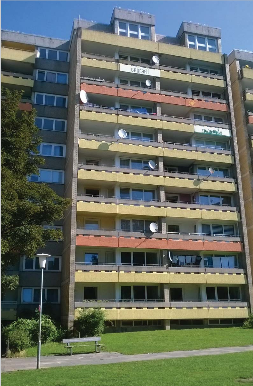
Hochhauslage mit Sanierungsbedarf (LHH)
