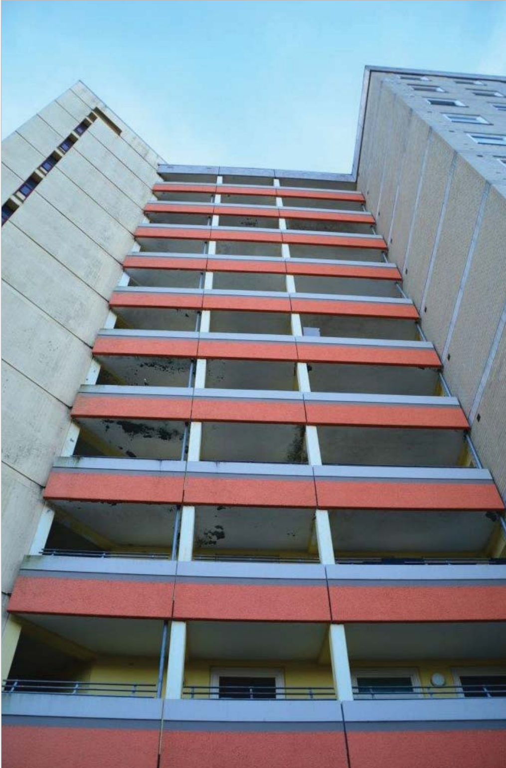
Sanierungsbedarf im Canarisweg (LHH)
