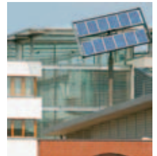
Stadtwerke Hannover AG photovoltaic installation
