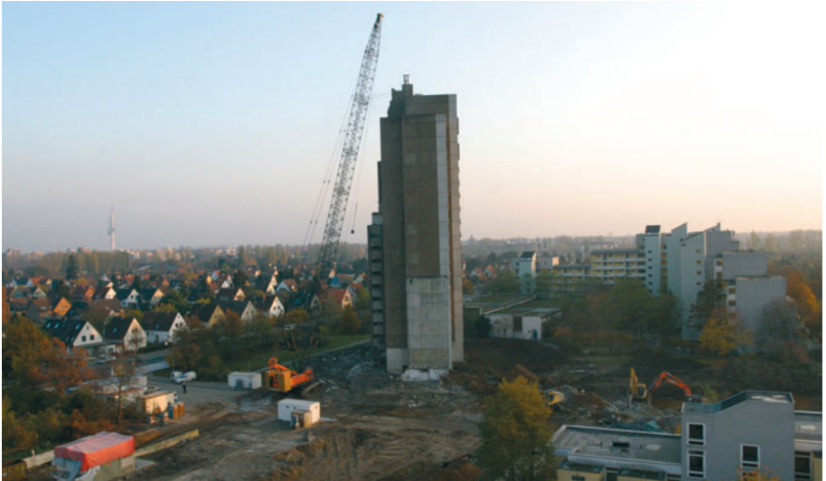
Das Ende der Epoche der Großwohnsiedlungen – Abriss des 18-geschossigen Hochhauses im Klingenthal in Hannover-Vahrenheide ...
