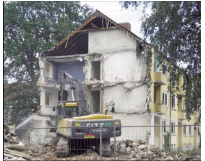
Vier Wochen dauerte der Abriss. Etwa 100 Lkw-Fuhren waren nötig, um das Material abzutransportieren. Die Abbruchgrube wurde mit rund 270 Tonnen Sand verfüllt.
